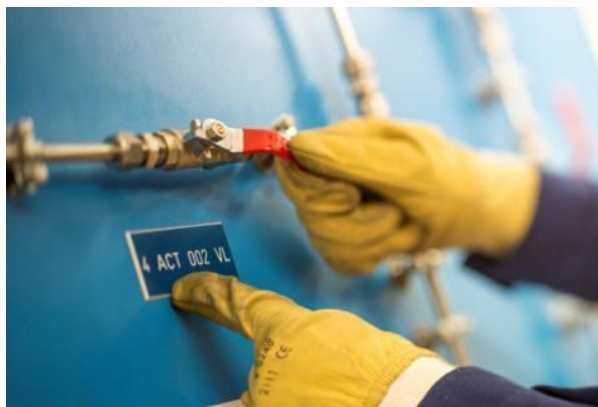
FIG. 3.1 – Étiquetage et repérage des équipements avant intervention
